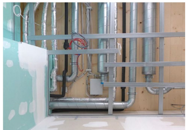
Abb. 69 - Installationsführung in der abgehängten Decke
